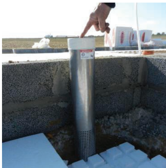
Isola Radon Sugbrønd
